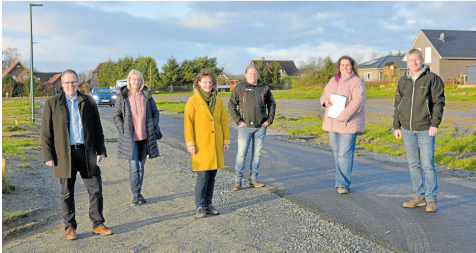
Auf der neuen Baustraße treffen sich Vertreter von Bauunternehmen, Planungsbüro und Kommune zur Abnahme.
