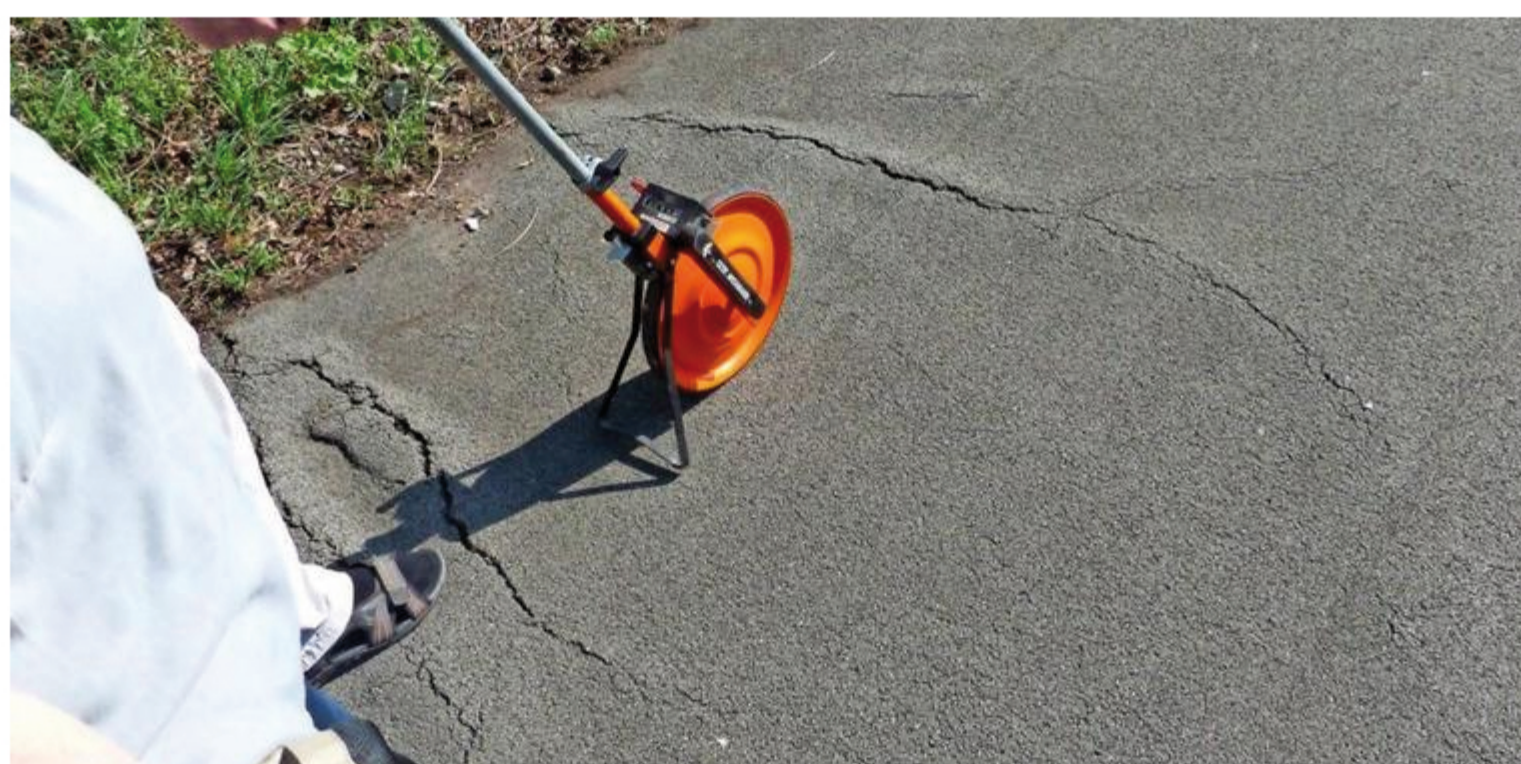
Zur Buckelpiste wurde der Radweg durch wucherndes Wurzelwerk, das den Belag hochgedrückt hat. Quelle: Christiane Hoffmann
