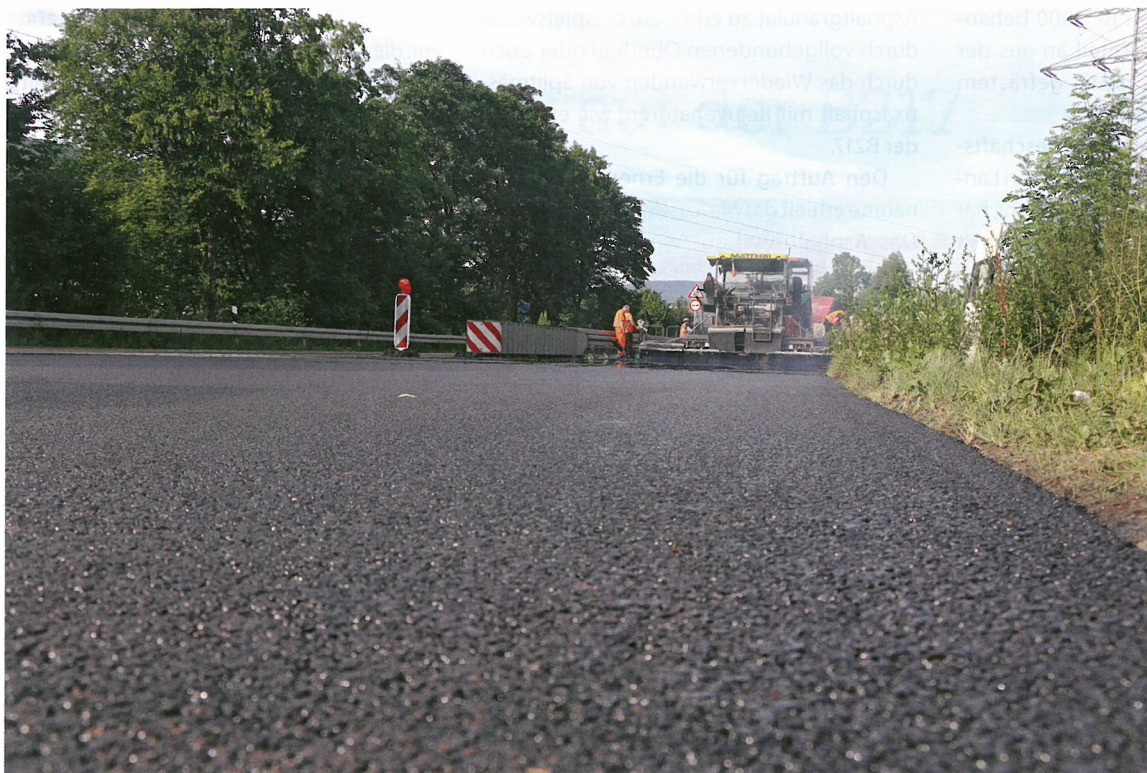
Auf der B217 wurde Splittmastixasphalt eingebaut, dem das Additiv Sylvaroad RP 1000 zugegeben worden ist.
